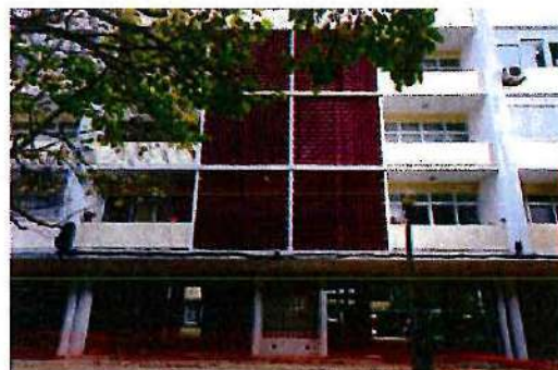
Fig. 36. Vista parcial da Rua Pedro Ivo, bloco onde se observam as grelhagens de cerâmica originais. PM, 20 de novembro de 2019.
