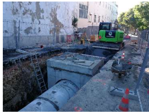
Colectores da Rua Maria Pia
